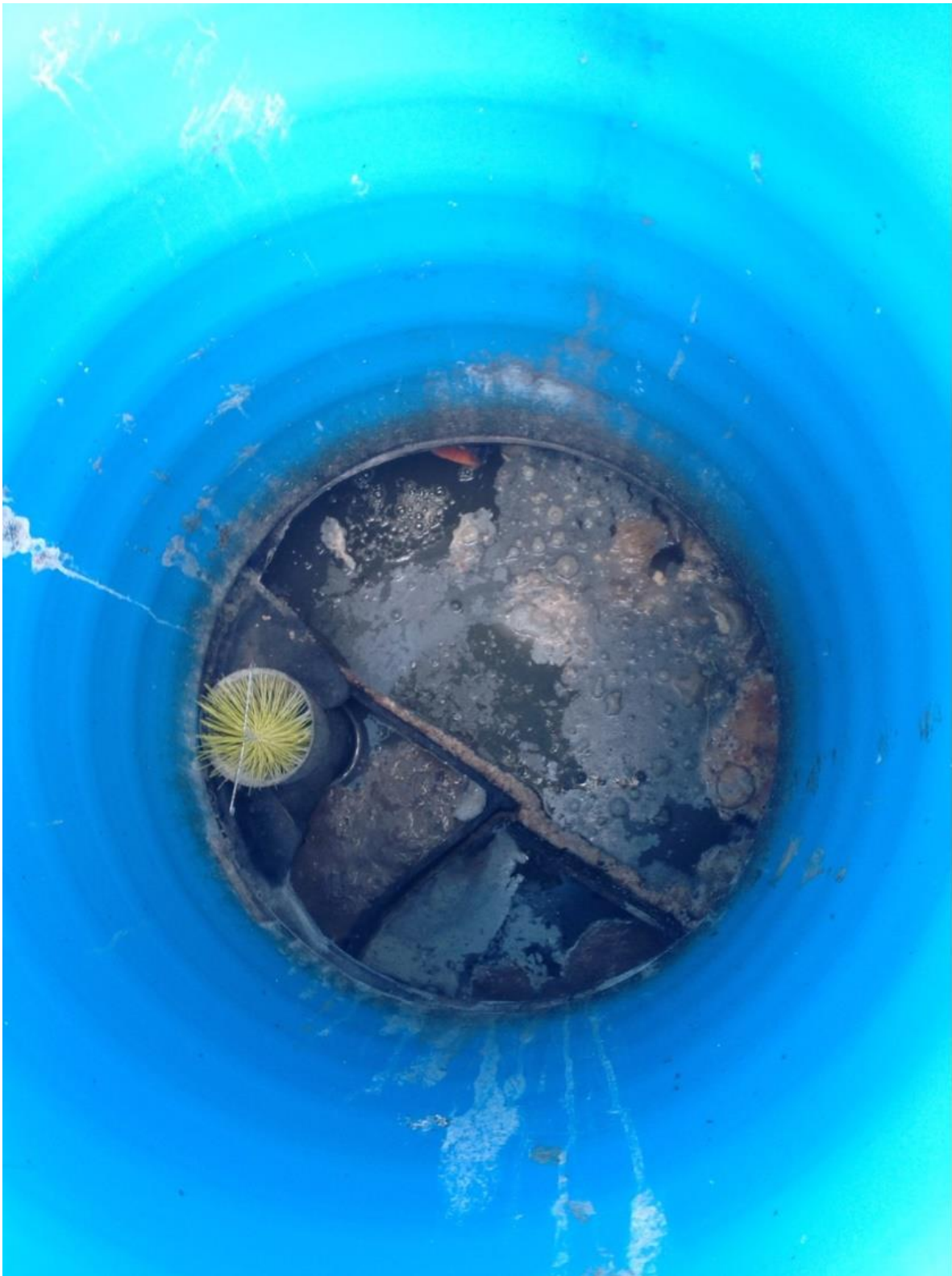
Figur 3. Är ett exempel på en gulklassificerad brunn dock med anmärkning på trolig spricka mellan första och andra skiljeväggen.
